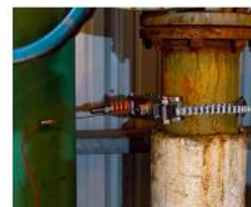
Sisteme de monitorizat grosimea conductelor acoperite
